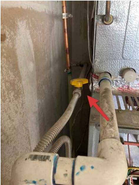
No sediment trap
