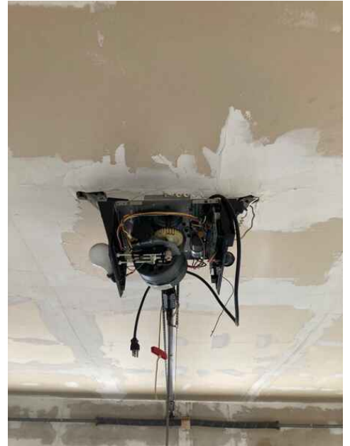
Garage door motor
